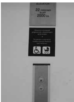
エレベーター利用者の表示
